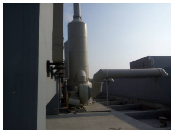
碱液喷淋吸收塔
